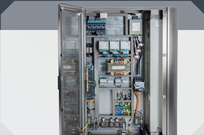
Verbrauch erfassen: intelligentes Monitoring für nachhaltigen Betrieb.
